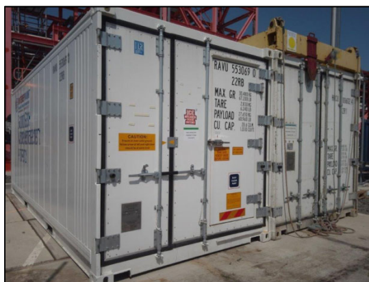
Фото 3 Морозильная установка контейнерного типа
