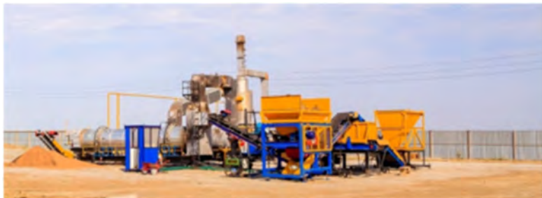
Фото 41 Общий вид инсинератора ИН-50.5М
