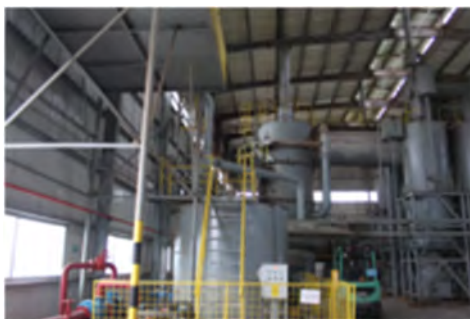
Фото 42 Общий вид вращающейся печи
