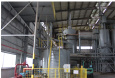
Фото 43 Общий вид вращающейся печи
