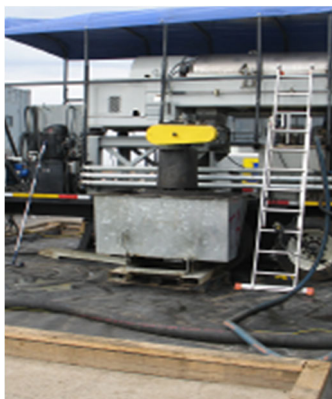
Фото 35 Мобильная установка по переработке нефтешлама
