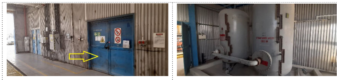
Фото 17 Помещение и резервуары временного накопления отработанных масел на АРП-2, 3
