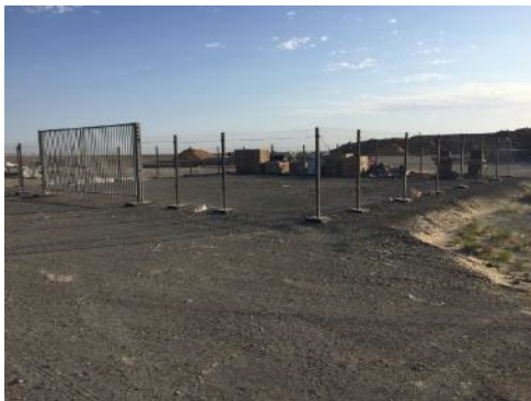
Фото 5 Площадка для временного сбора и накопления некондиционного металлолома
