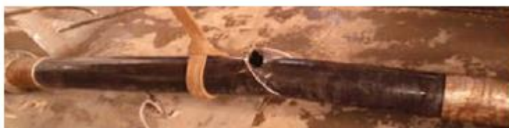
Рисунок 33.12 Частично разрушенная труба
