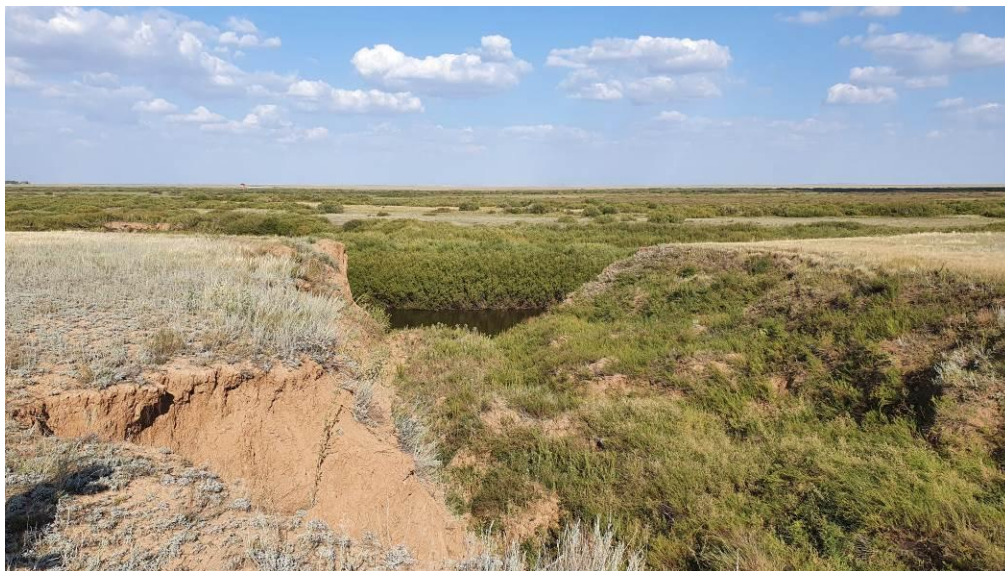
Рис. 4.17. Промоина у автомобильной дороги на ПК 119.
