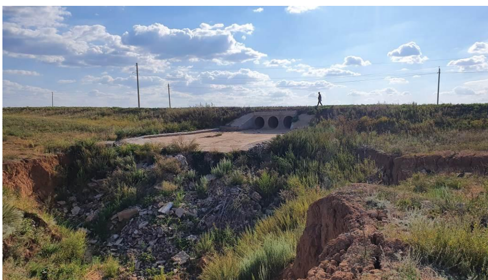
Рис. 4.13. Промоина у автомобильной дороги на ПК 127.
